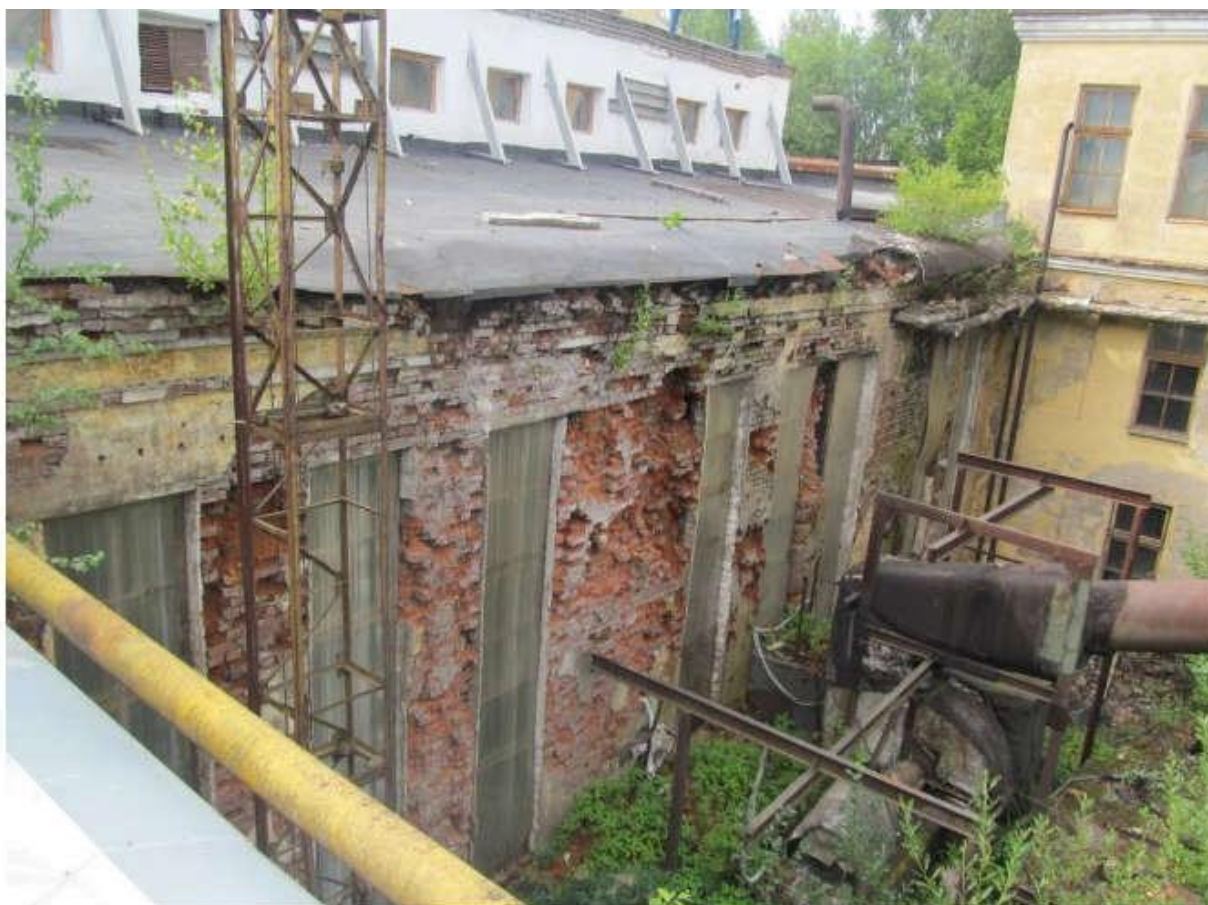
Рисунок 10 Следы замачивания, разрушение и эрозия кирпичной кладки на глубину до 300мм на фасадной поверхности стен
