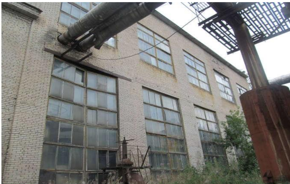
Рисунок 19 Поражение гнилью, деструкция древесины конструкций рам оконных заполнений; разрушение и утрата элементов остекления.
