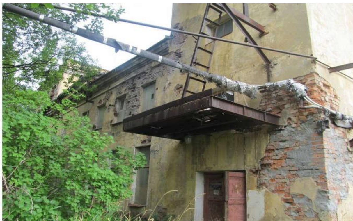
Рисунок 11 Следы замачивания, разрушение и эрозия кирпичной кладки на глубину до 200мм на фасадной поверхности стен
