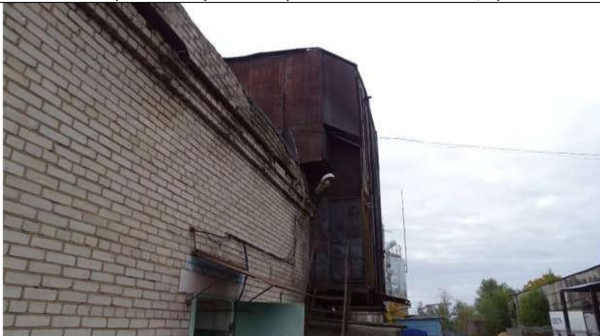
Рисунок 33 Торцевой фасад здания: следы замачивания, разрушение и эрозия кирпичной кладки на глубину до 100мм на фасадной поверхности в верхней части стен основного объема здания
