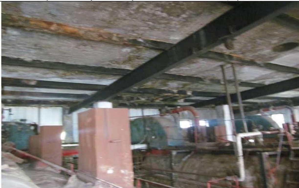
Рисунок 14 Следы протечек, разрушение окрасочного слоя, разрушение защитного слоя бетона, оголение и коррозия арматуры на нижней поверхности плит покрытия. Разрушение окрасочного слоя, коррозия балок покрытия
