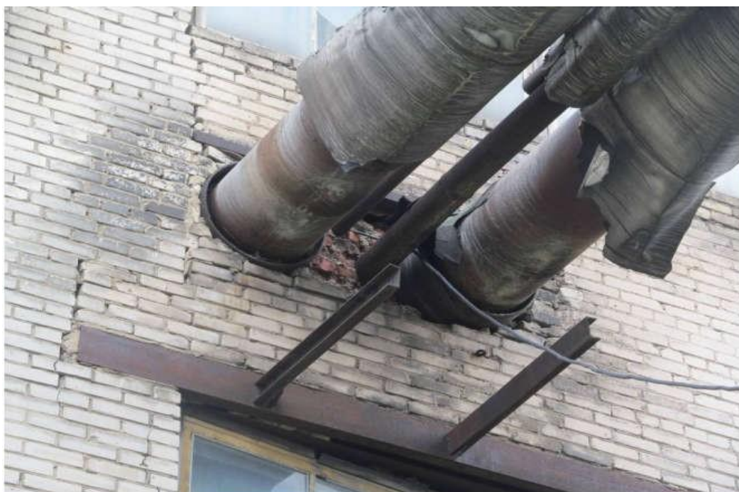
Рисунок 18 Наклонные и вертикальные трещины по кирпичной кладке фасадной поверхности стены шириной до 10мм в межоконном поясе в месте прохода магистральных трубопроводов.
