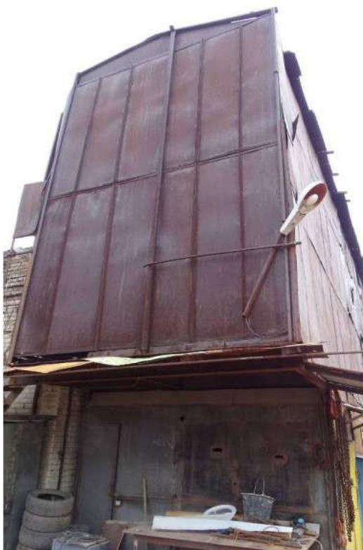
Рисунок 34 Торцевой фасад пристройки для размещения бака- аккумулятора горячей воды: поверхностная, на отдельных участках сквозная коррозия обшивки стенового ограждения
