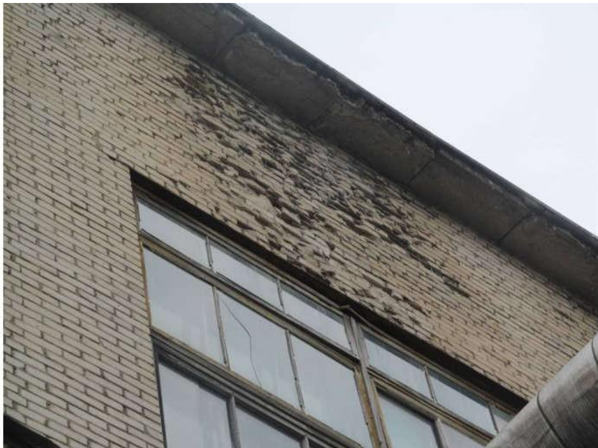
Рисунок 16 Следы замачивания, разрушение и эрозия кирпичной кладки на глубину до 120мм на фасадной поверхности стен
