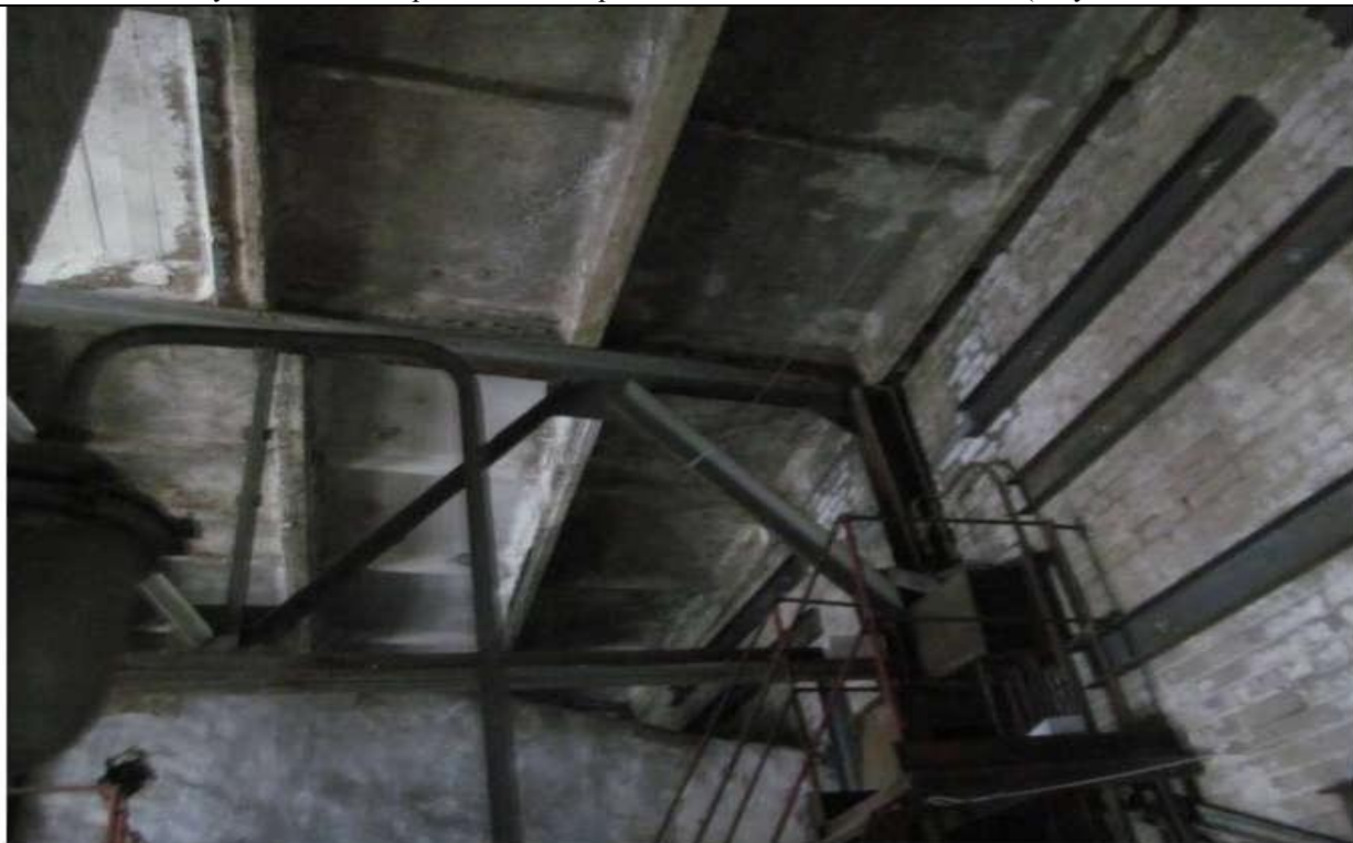
Рисунок 23 Следы протечек, разрушение окрасочного слоя, разрушение защитного слоя бетона на нижней поверхности плит покрытия
