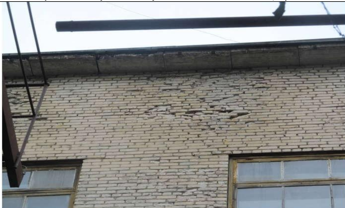
Рисунок 17 Следы замачивания, разрушение и эрозия кирпичной кладки на глубину до 120мм на фасадной поверхности стен
