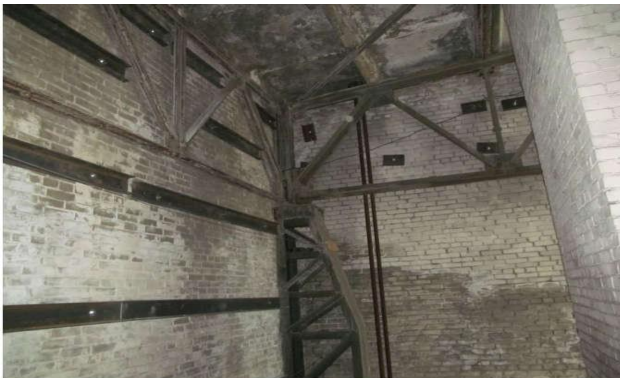
Рисунок 22 Следы протечек, разрушение окрасочного слоя, разрушение защитного слоя бетона на нижней поверхности плит покрытия
