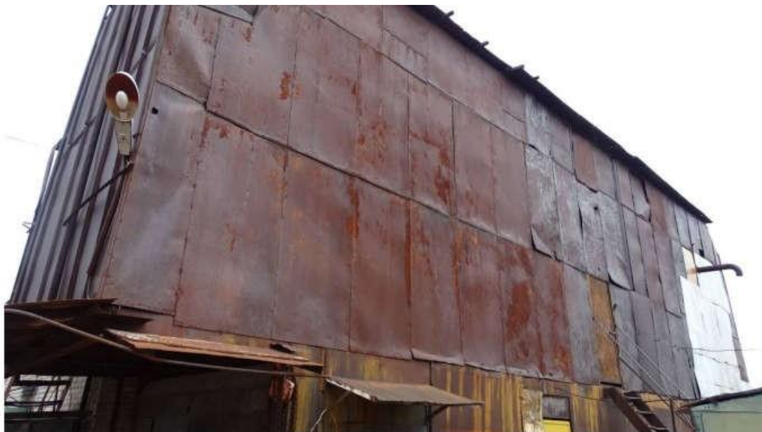
Рисунок 35 Фасад пристройки для размещения бака-аккумулятора горячей воды: поверхностная, на отдельных участках сквозная коррозия обшивки стенового ограждения
