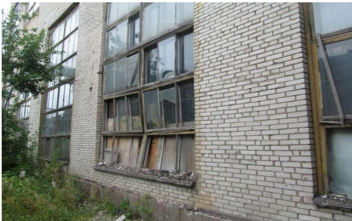
Рисунок 20 Поражение гнилью, деструкция древесины конструкций рам оконных заполнений; разрушение и утрата элементов остекления.
