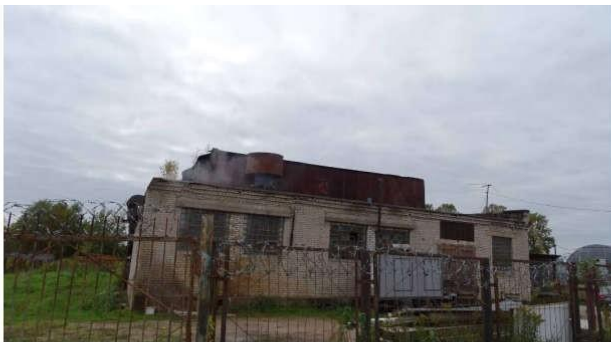
Рисунок 32 Общий вид фасада здания: следы замачивания, разрушение и эрозия кирпичной кладки на глубину до 100мм на фасадной поверхности в верхней части стен основного объема здания
