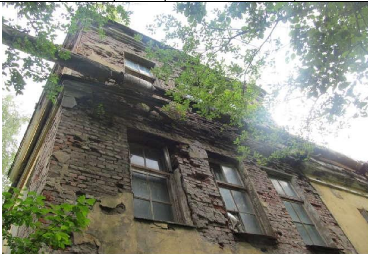
Рисунок 12 Следы замачивания, разрушение и эрозия кирпичной кладки на глубину до 200мм на фасадной поверхности стен
