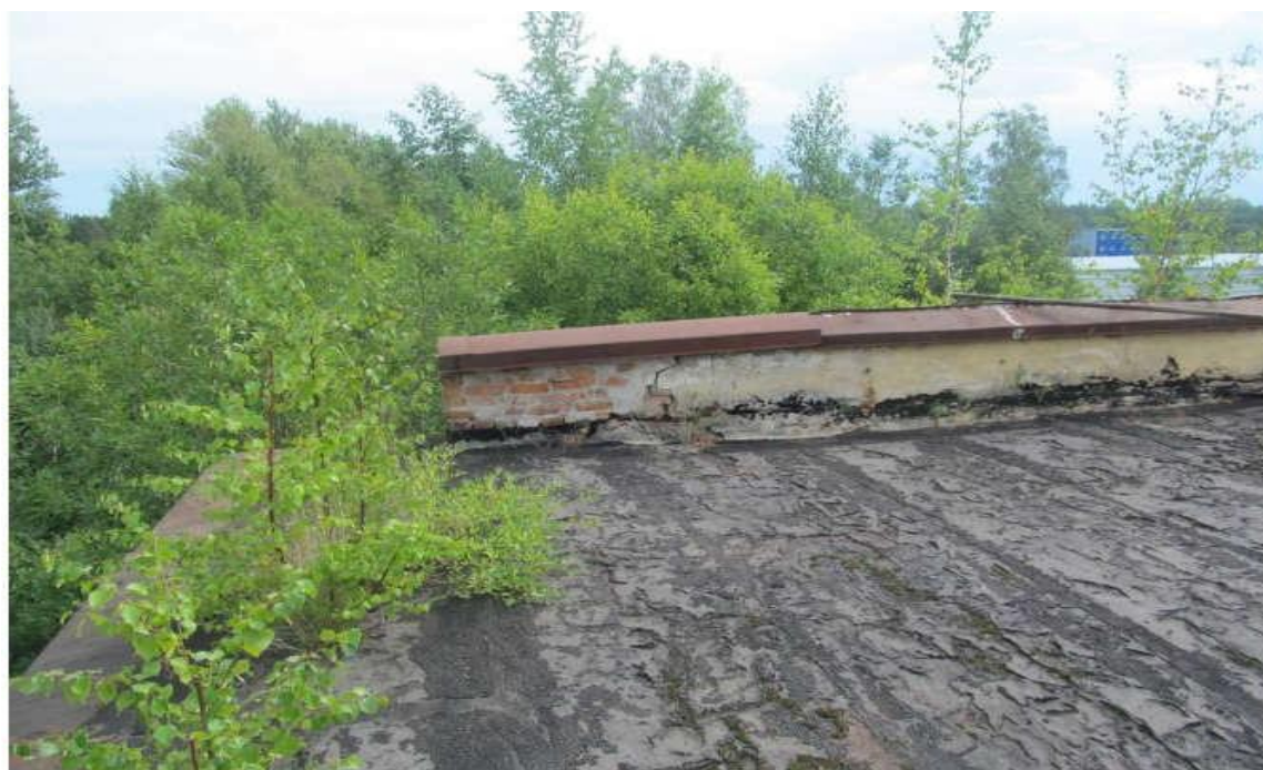
Рисунок 15 Трещины на поверхности, разрушение кровельного покрытие; произрастание растительности на поверхности кровли
