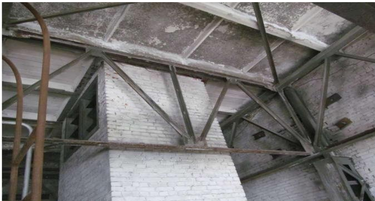
Рисунок 24 Следы протечек, разрушение окрасочного слоя, коррозия элементов ферм покрытия
