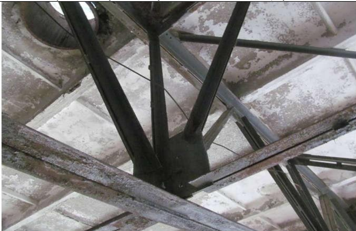
Рисунок 25 Следы протечек, разрушение окрасочного слоя, коррозия элементов ферм покрытия
