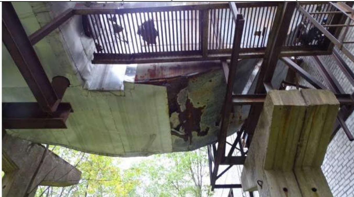
Рисунок 29 Нижняя часть дымовой трубы: разрушение заполнения швов между сборными ж/б элементами;
