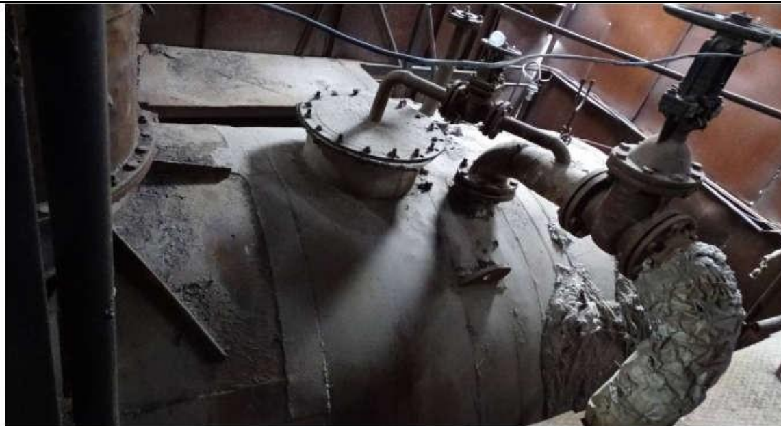
Рисунок 37 Общий вид бака-аккумулятора горячей воды: разрушение и полная утрата теплоизоляции бака; поверхностная, на отдельных участках сквозная коррозия бака
