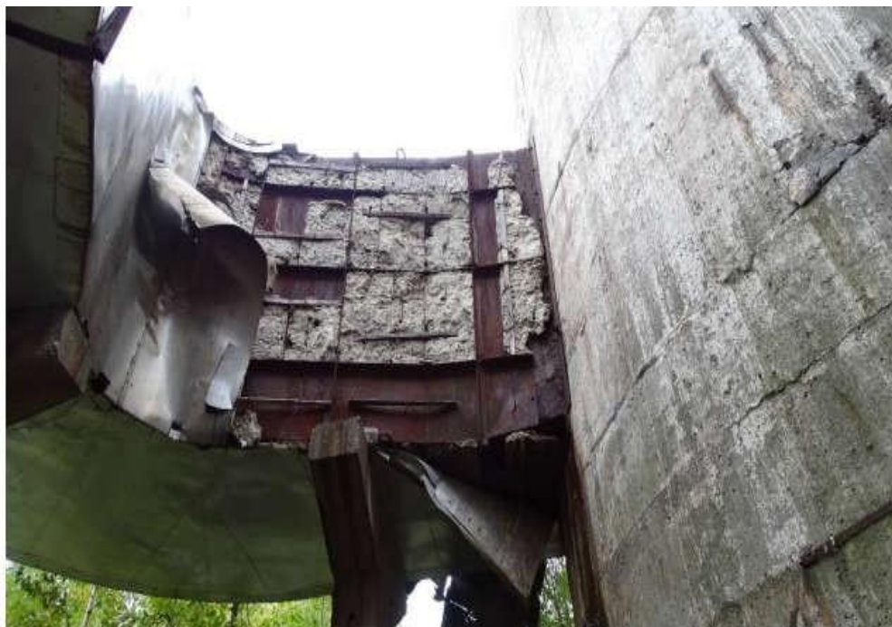
Рисунок 28 Нижняя часть дымовой трубы: разрушение заполнения швов между сборными ж/б элементами; разрушение защитного слоя, оголение и коррозия арматуры сборных ж/б элементов; разрушение и утрата теплоизоляции, коррозия металла вертикального дымового канала
