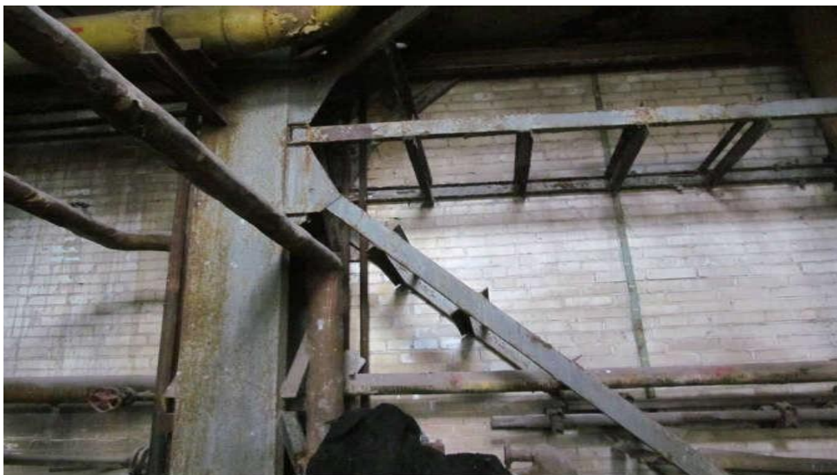
Рисунок 21 Следы протечек, разрушение окрасочного слоя, коррозия элементов колонн каркаса
