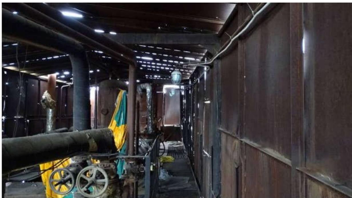
Рисунок 36 Помещение пристройки для размещения бака-аккумулятора горячей воды: поверхностная, на отдельных участках сквозная коррозия обшивки стенового и кровельного ограждения; поверхностная и сквозная коррозия несущих элементов стен и покрытия
