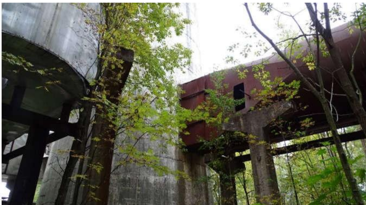
Рисунок 30 Нижняя часть дымовой трубы: разрушение заполнения швов между сборными ж/б элементами; разрушение защитного слоя, оголение и коррозия арматуры сборных ж/б элементов; разрушение и утрата теплоизоляции, коррозия металла вертикального дымового канала
