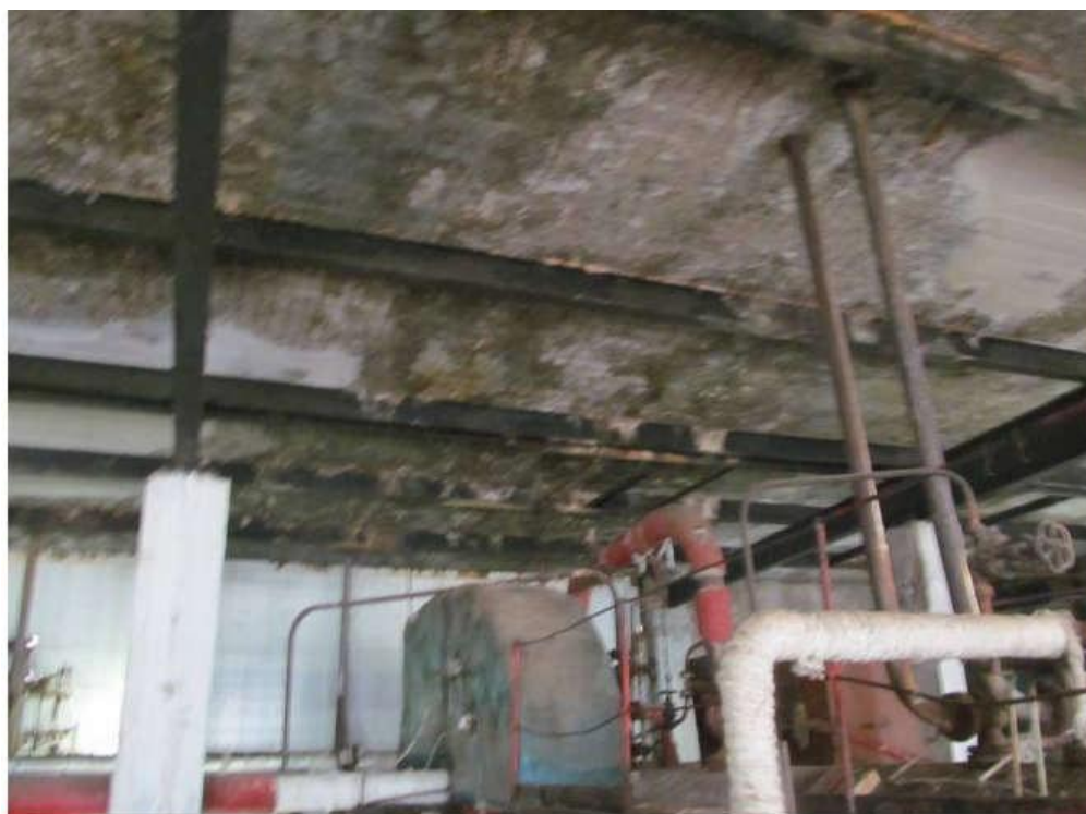
Рисунок 13 Следы протечек, разрушение окрасочного слоя, разрушение защитного слоя бетона, оголение и коррозия арматуры на нижней поверхности плит покрытия. Разрушение окрасочного слоя, коррозия балок покрытия
